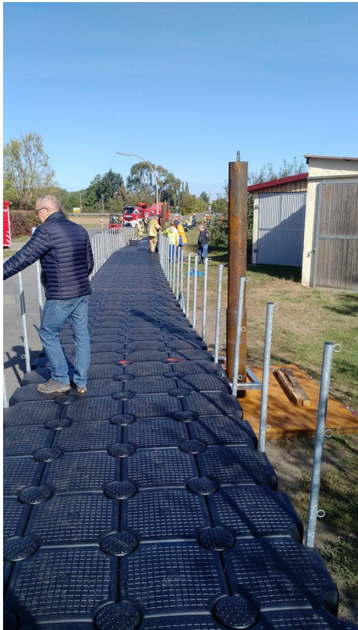
Hochwassersteg in Augsfeld
